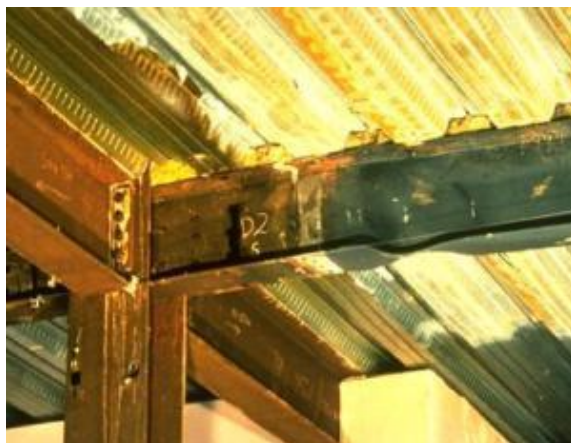
گسیختگی خمشی (کمانش) در تیرهای فولادی
