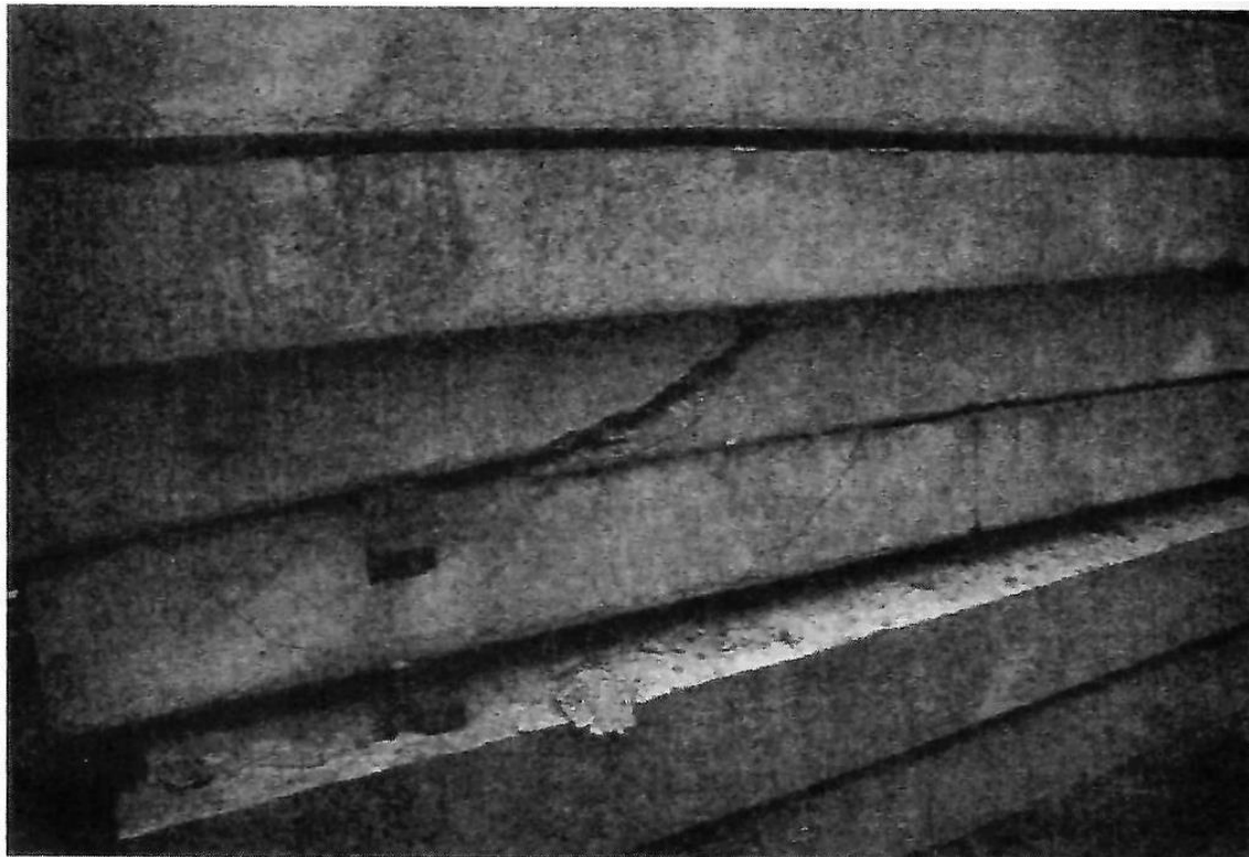
شکل ۳-۵ دالهای آسیب دیده ناشی از بی دقتی در انبار کردن
