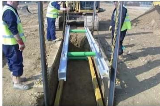
شکل ۵) نصب قاب‌ها که شامل دو بخش آلومینیومی و فولادی بافاصله ثابت هستند
