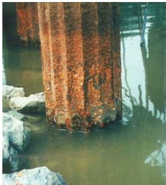
شکل ۲. خوردگی شمع‌های فولادی
