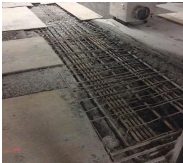
تراکم آرماتوربندی در یک تیر بعد از خرابی
