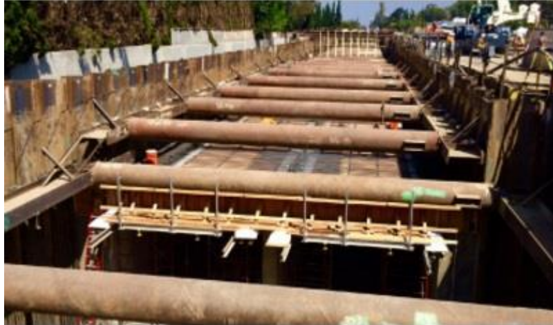
شیار مربوط به سیستم BART در زیر خطوط تسهیلات موجود در تقاطع جاده Sierra با خیابان Lundy ساخته می‌شود (منبع عکس: ۲۰۱۵، Courtesy of Michael Rooney).
