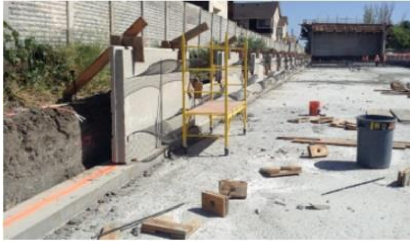
از بتن سبک مشبک به‌عنوان پشت‌بند و به‌منظور تقویت و استحکام دیوارها در ایستگاه آینده Berryessa استفاده شد (منبع عکس: ۲۰۱۵، Courtesy of Santa Clara Valley Transportation Authority).
