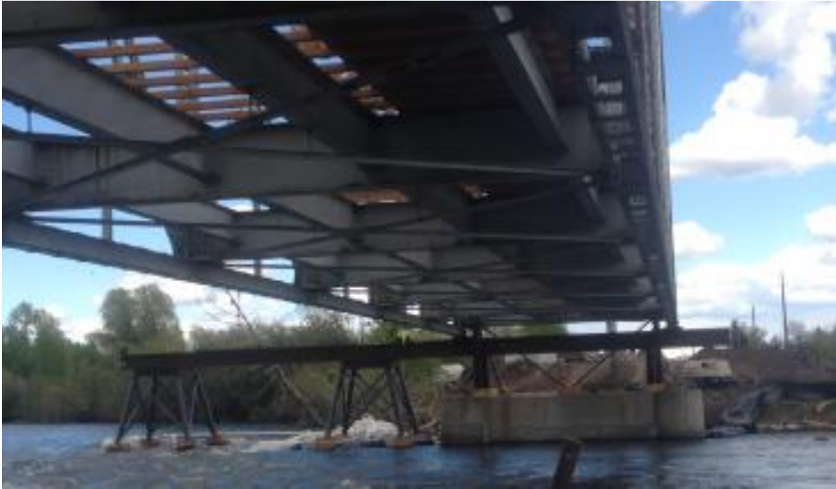
پس از حذف آسفالت و مصالح عرشه بتنی، فونداسیون موقت در رودخانه قرار گرفت و یک سیستم بالا برنده برای بلند کردن پل قدیمی ایجاد شد.
