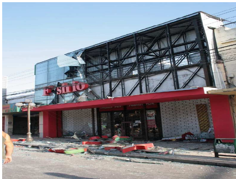
شکل (ت-۴-۱۶): فروریزی شیشه‌ها در یک سازه در اثر زلزله شبیلی در سال ۲۰۱۰ (FEMA E-74, 2011)
