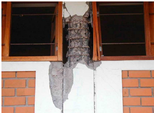
شکل (ت-۴-۲۲): خسارت بوجود آمده در ستون کوتاه در زلزله پرو در سال ۲۰۰۱ (FEMA E-74, 2011)
