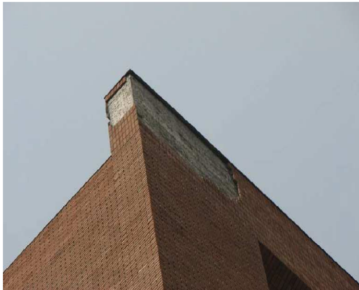
شکل (ت-۴-۱۵): فروریزی آجرهای نما در یک ساختمان در اثر زلزله شبیلی در سال ۲۰۱۰ (FEMA E-74, 2011)
