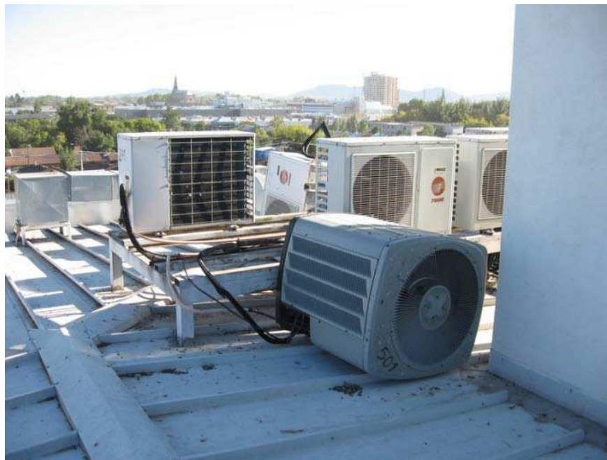
شکل (ت-۴-۴۳): نمایی دیگر از خسارات وارد شده بر کولرها و دیگر تجهیزات در زلزله سال ۲۰۱۰ شیلی، این تجهیزات عموماً در تمام ساختمان‌ها وجود دارند (FEMA E-74, 2011)
