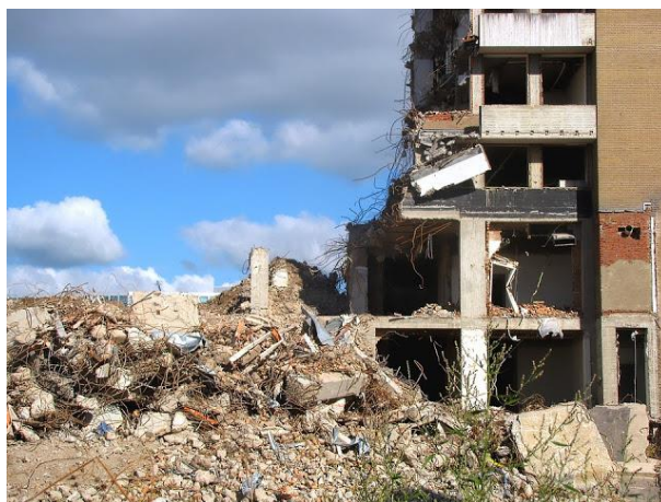
تخریب سازه‌ی ساختمان
