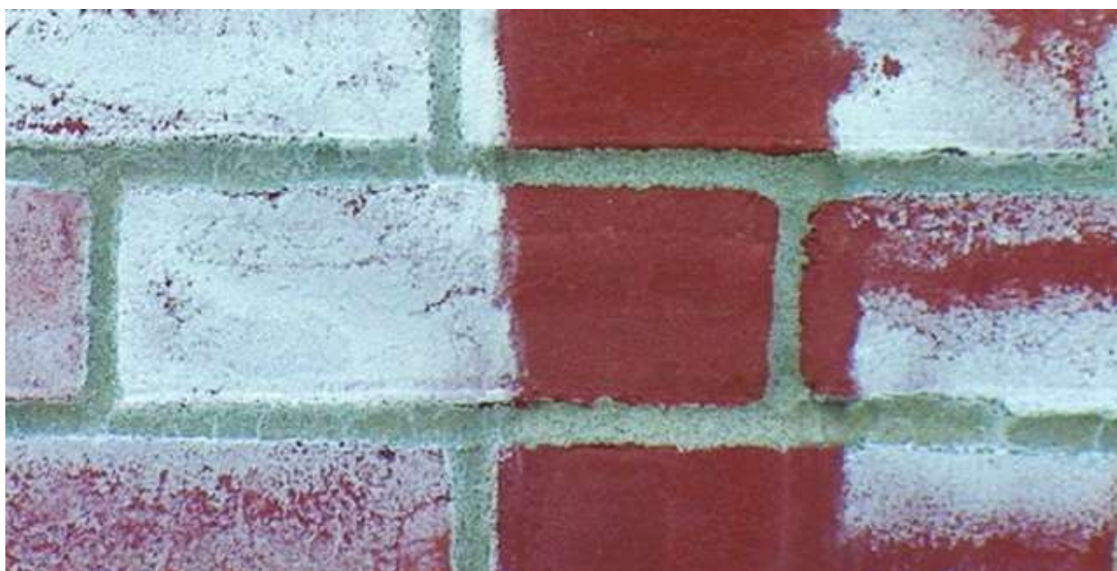
شکل ۱: شوره بر روی دیوار آجری
