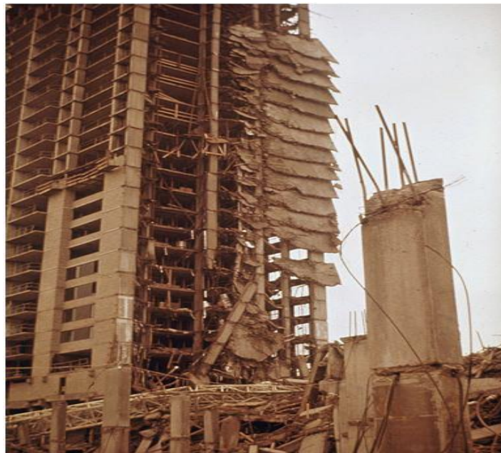
شکل ۲ خرابی پیشرونده در ساختمان تجاری خط آسمان - matdl.org/failurecases
